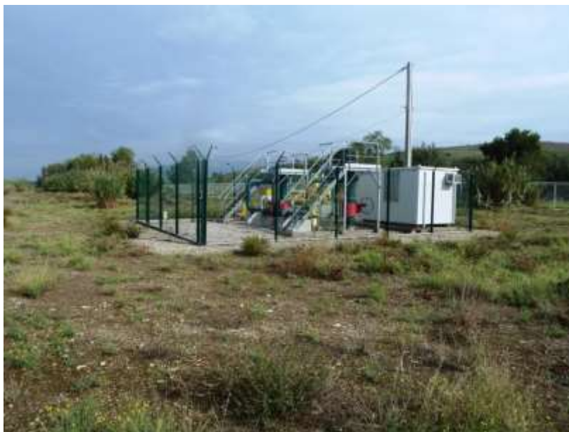
Figure 5. Illustration d'un poste de sectionnement du réseau de gaz
