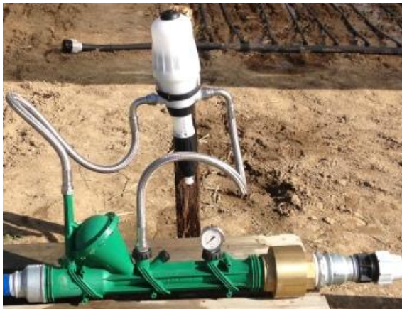
Figure 4 : Doseur en phase de test in situ ( in situ test with dosing pump)
